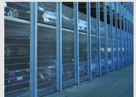
Abb. 6: Feuerverzinkter Stabgitterzaun an einem Parkhaus
