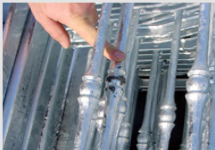
Abb. 4: Fehlstellen durch unzureichend entfernte alte Beschichtungen.
