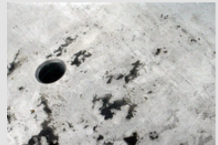
Abb. 6: Fehlstellen durch unzureichend entfernte Farbreste.
