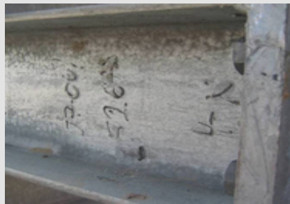
Abb. 5: Nicht entfernte Signierungen verursachen Fehlstellen im Zinküberzug.
