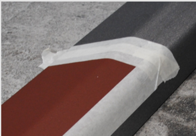
Abb 3: Durch Abkleben können hitzebeständige Farbbeschichtungen zur Vermeidung der Zinkannahme exakt appliziert werden.
