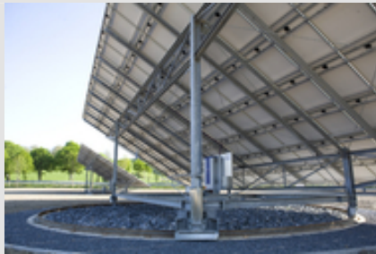
➔ Abb. 4: Die Feuerverzinkung ist dabei - ob Strommaste oder Energieerzeugung
