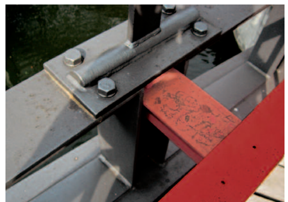
➔ Detailfotos einer Inspektion der Beschichtung nach 27 Jahren.
