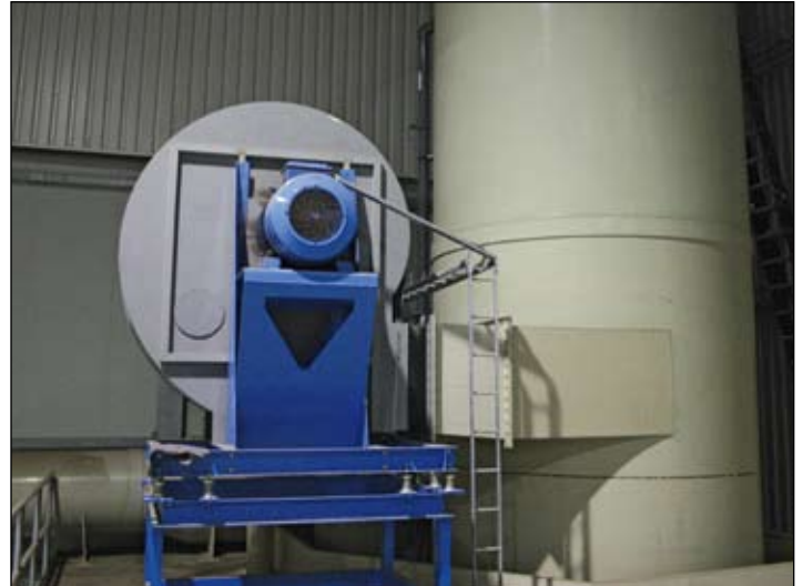
2 Filteranlage einer eingehausten Säurewirtschaft
