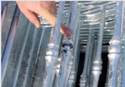
Abb. 4: Fehlstellen durch unzureichend entfernte alte Beschichtungen.
