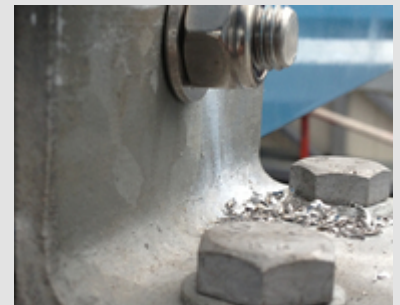
Abb. 5: Bohrspäne oder Reste von Schweißelektroden können "Fremdrost" verursachen, wenn sie nicht entfernt werden.
