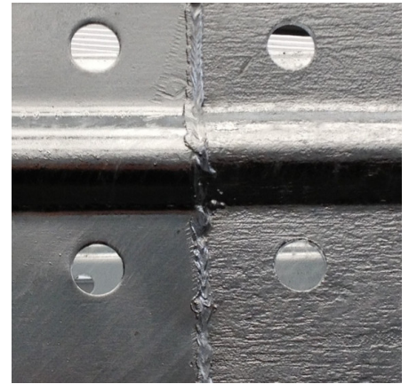
Abb 2: Die Kombination von alten, rostnarbigen mit neuen Stahlteilen verursacht sichtbar, unterschiedliche Zinküberzüge.
