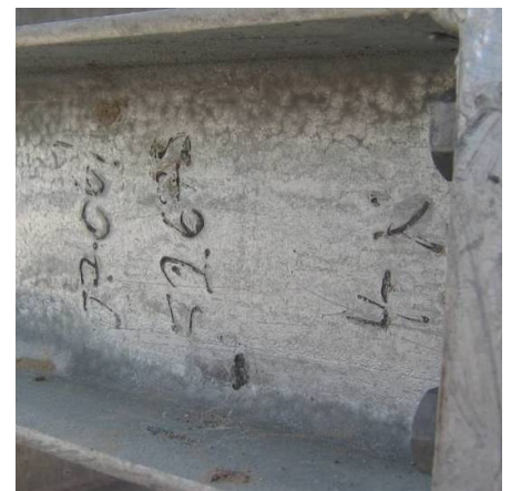
Abb. 1: Fehlstellen im Zinküberzug durch nicht entfernte Signierungen mit Farbe
