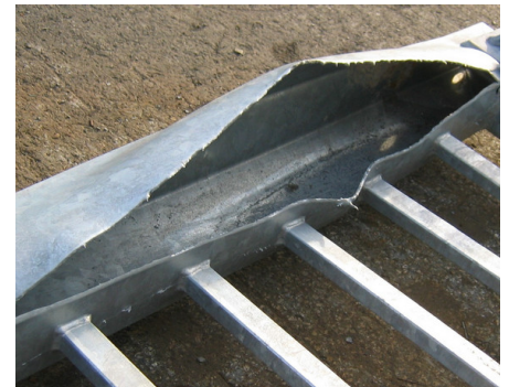
Abb. 1: Geplatztes Rohr aufgrund unzureichender Entlüftungsöffnungen
