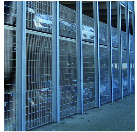
Abb. 6: Feuerverzinkter Stabgitterzaun an einem Parkhaus
