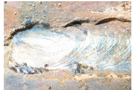
Abb. 1: Einbrandkerben können Verzinkungsfehler verursachen.
