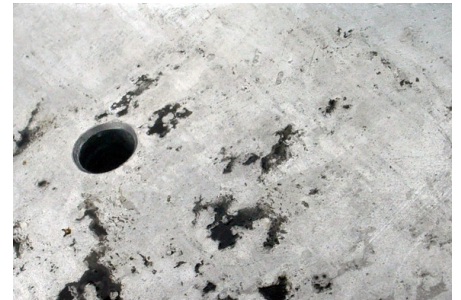
Abb. 6: Fehlstellen durch unzureichend entfernte Farbreste.
