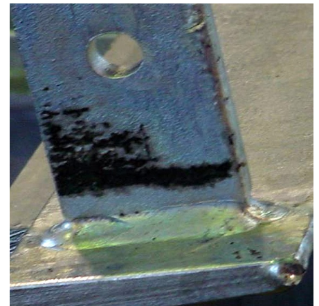
Abb. 3: Nicht entfernte Schweißsprayrückstände verursachen Fehlstellen im Zinküberzug.
