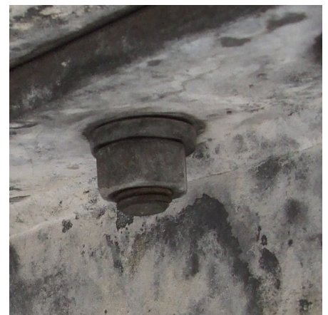
Abb. 4: Starker Weißrost führt zur Beeinträchtigung des Zinküberzuges. Nacharbeit wird eventuell notwendig.
