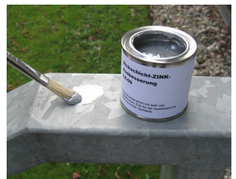
Abb. 6: Fehlstellen fachgerecht ausbessern. Mehr hierzu im Arbeitsblatt E.4.
