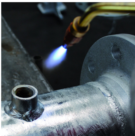
Abb 1: Überflüssige Zinktropfen können mit weicher Flamme abgeschmolzen und danach mit Drahtbürste oder Blechspachtel beseitigt werden.
