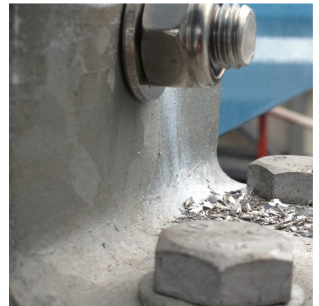
Abb. 5: Bohrspäne oder Reste von Schweißelektroden können "Fremdrost" verursachen, wenn sie nicht entfernt werden.
