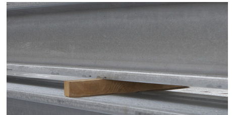
Abb. 1: Richtiges Handling (z.B. Lagerung) von verzinkten Stahlteilen auf Baustellen ist wichtig.
