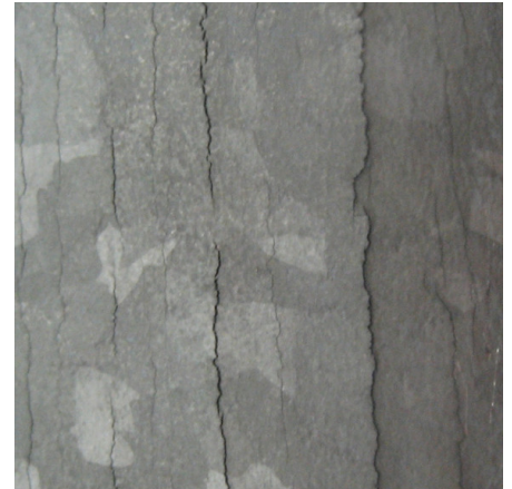
Abb. 4 Rissiger, abplatzender Zinküberzug an einer Stahlstütze infolge eines Frostschadens
