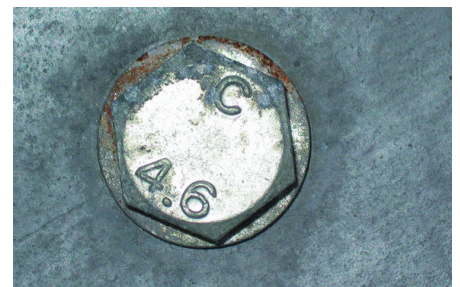
Abb.3: Falsch - Galvanisch verzinkte Schraube mit beginnendem Rotrost in feuerverzinkter Stahlkonstruktion.
