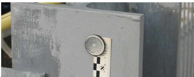
Abb. 3: Falsch: Kleine Fehlstellen werden oft sehr großflächig ausgebessert.
