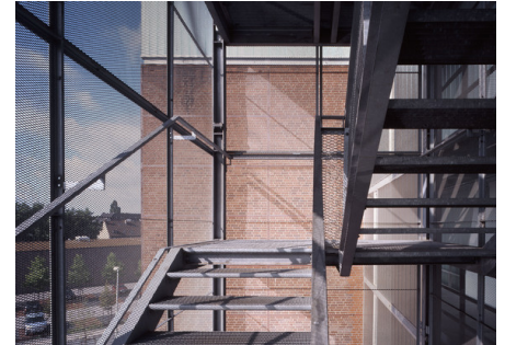
Abb. 1: Der Korrosionsschutz durch Feuerverzinken ist in Normen geregelt.
